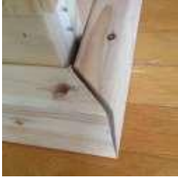
Poor Mitre Finish
