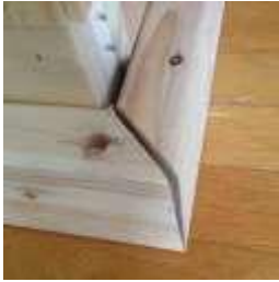
Poor Mitre Finish
